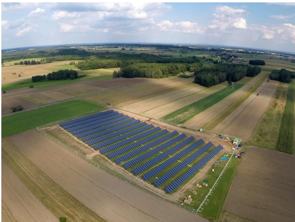
Elektrownia Słoneczna R.Power - Jedwabne
